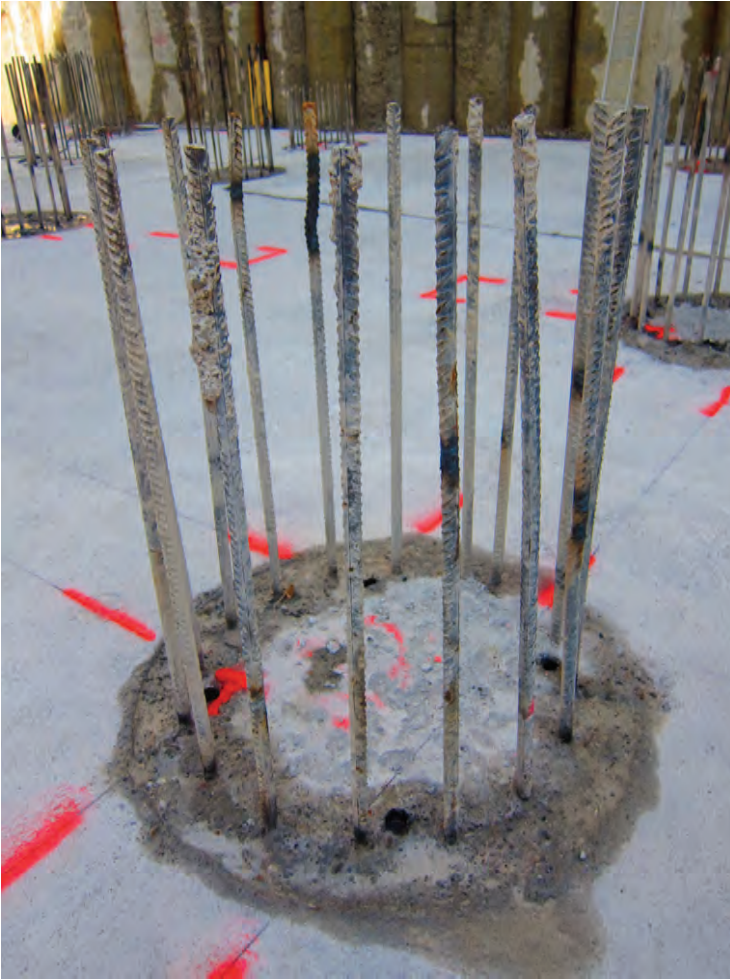
Bild 13 Pfählkopfbereich im Bereich der vermeintlich fehlerhaften Stelle B vom Bild 12
